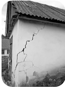
Grietas en las paredes
