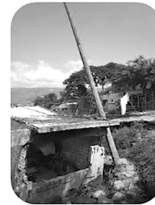
Inclinación de postes
