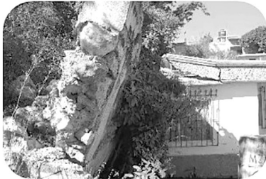
Inclinación de muros
